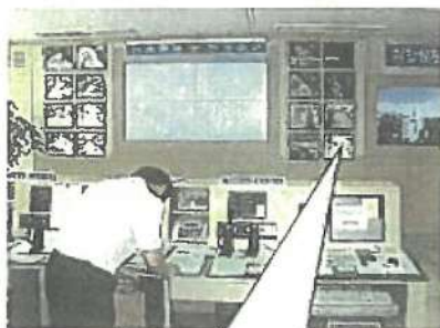
警察署におけるCCTVによる取替り等の状況
